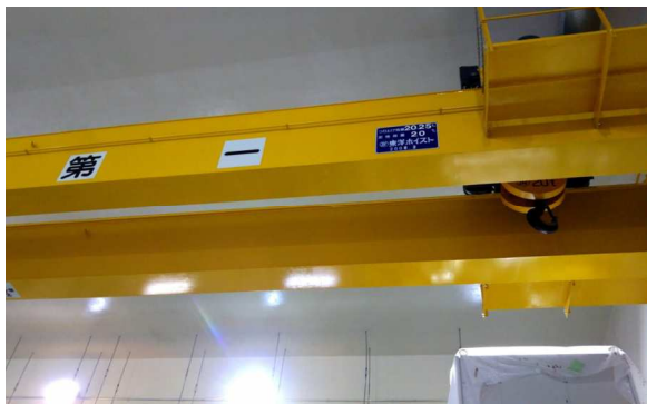
写真 20 t 天井クレーン
