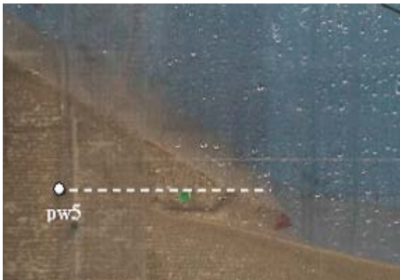
写真-2 水平方向斜面崩壊
