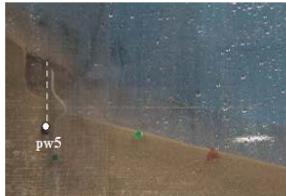
写真-3 鉛直方向斜面崩壊
