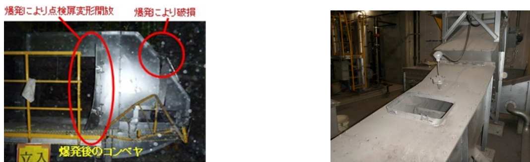
Fig.1 水素爆発後の灰処理設備の破損 (1)(2)
