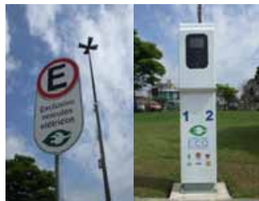
電気自動車充電機
