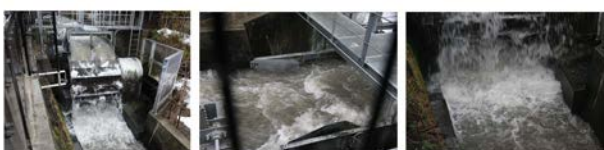
左: 元気くん3号, 中: 上流除塵機, 右: 発電機および
