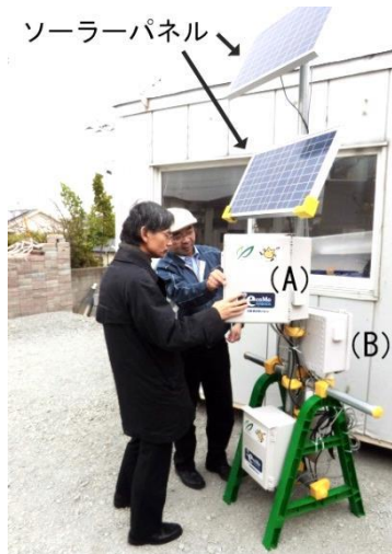
図4 設置システムの機器収納の様子
