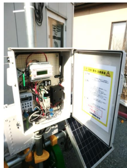
図6 設置したシステム機器(A)
