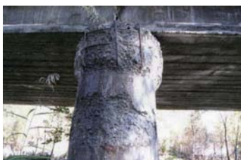
コンクリート凍害事例
