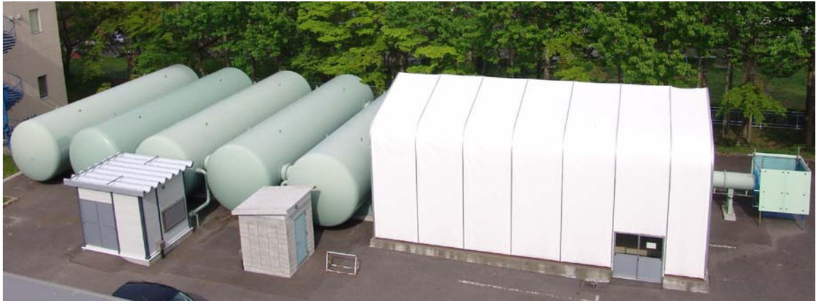
図2 真空タンクを5基に増設した超音速風洞の全景
