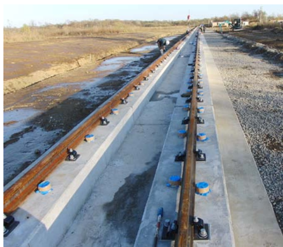
図1 白老エンジン実験場に設置したフルサイズ高速走行軌道実験設備(軌道長:300m)
