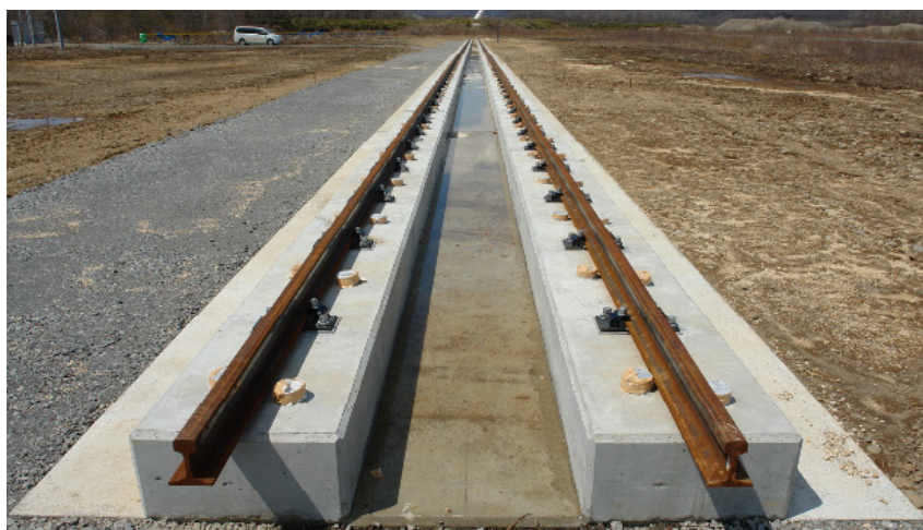
図 2 フルスケール高速走行軌道装置
