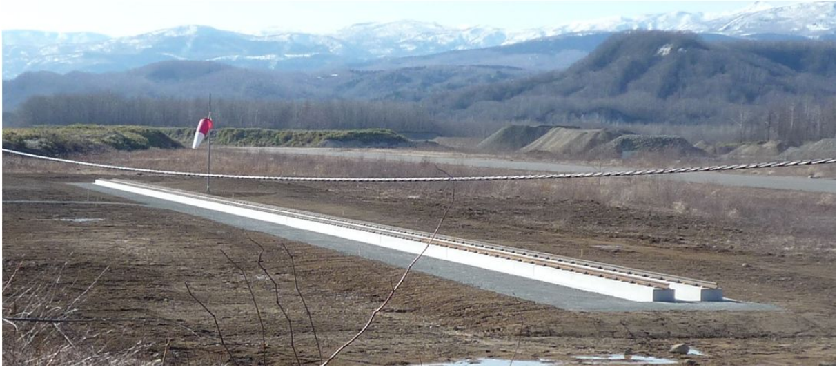
図 14：平成20年度に建設したフルサイズ高速走行軌道(全長150 m)の全景 (右側奥に滑走路が見える)
