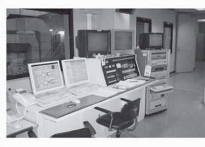
(c) 風洞試験装置の中央制御盤
