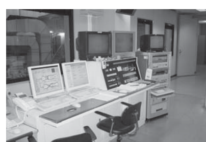
(c) 風洞試験装置の中央制御盤
